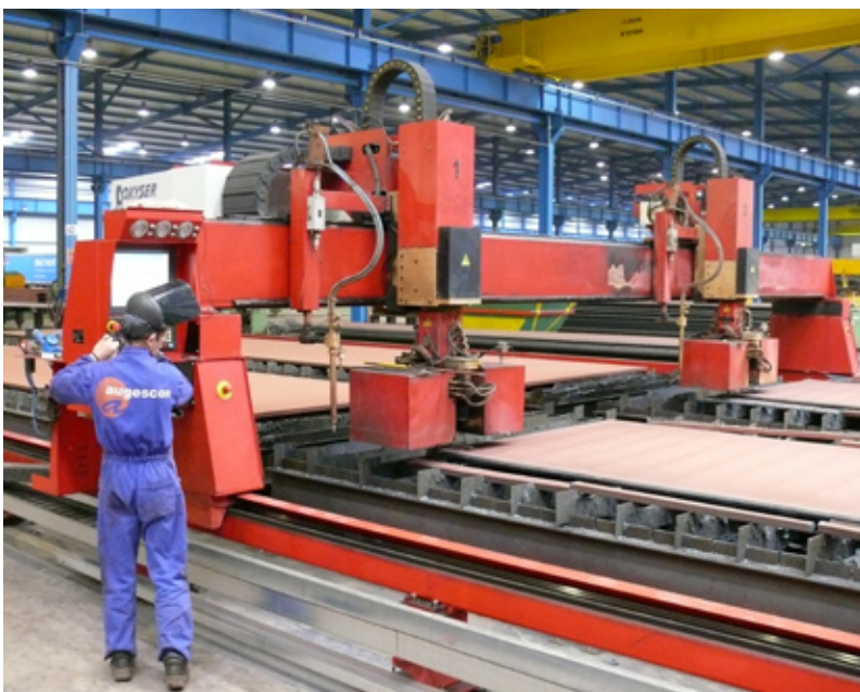
CNC-System kontrolliert 16 Achsen einschließlich 2 Oxy-Acetylen-Fräsköpfe
