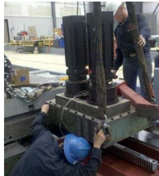
Zusammenbau des Tandem-Laufwerk-Antriebsrads, welches durch ein NUM MDLÜ3 gesteuert wird
