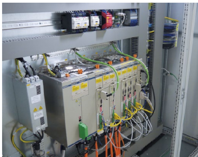
Detailansicht Schaltschrank: Flexium + 68 CNC-System mit NUMDrive X mit integrierter Safety-Lösung.
