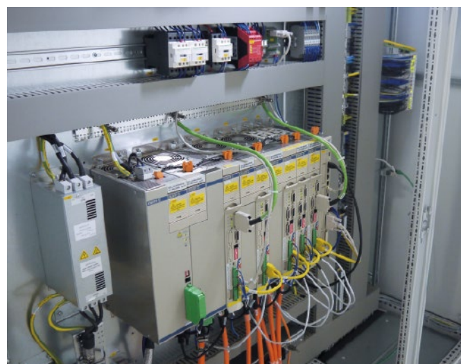
Vue détaillée de l'armoire électrique : Système Flexium + 68 CNC avec NUMDrive X avec solution de sécurité intégrée.
