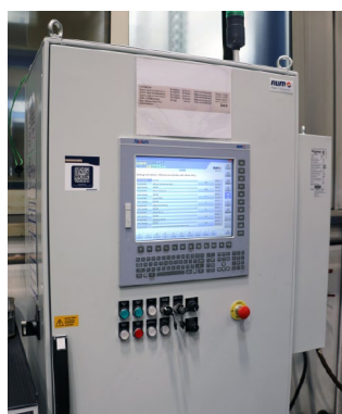
HMI ottimizzato dopo il retrofit
