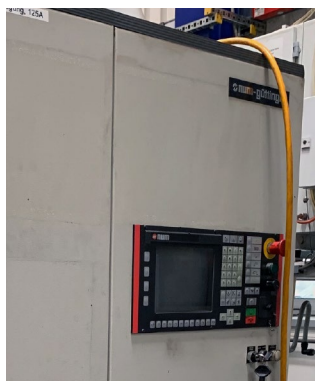
HMI prima del retrofit
