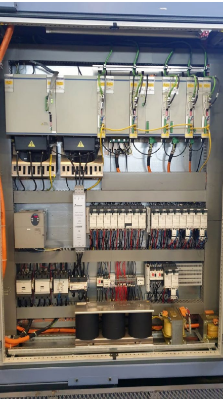
Schaltschrank mit MDLL-Netzteil und MDLUX-Antrieben
