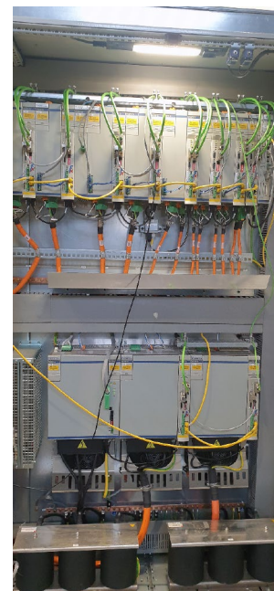
Quadro elettrico centro di lavoro con Drive MDLUX
