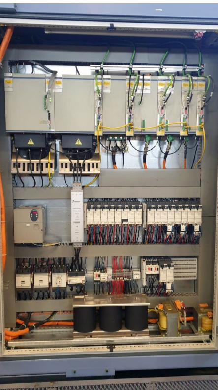
Quadro Elettrico con alimentatore MDLL e azionamenti MDLUX
