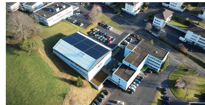
Système photovoltaïque sur le bâtiment de l'entreprise à Teufen
