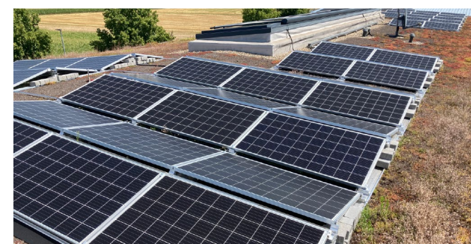
Système photovoltaïque sur le bâtiment de l'entreprise à Holzmaden
