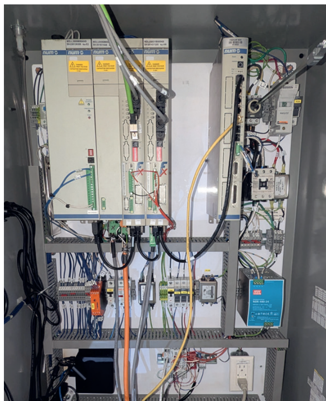
Intérieur de l'armoire de commande
